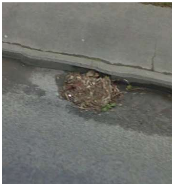
D16 Blocked sump
