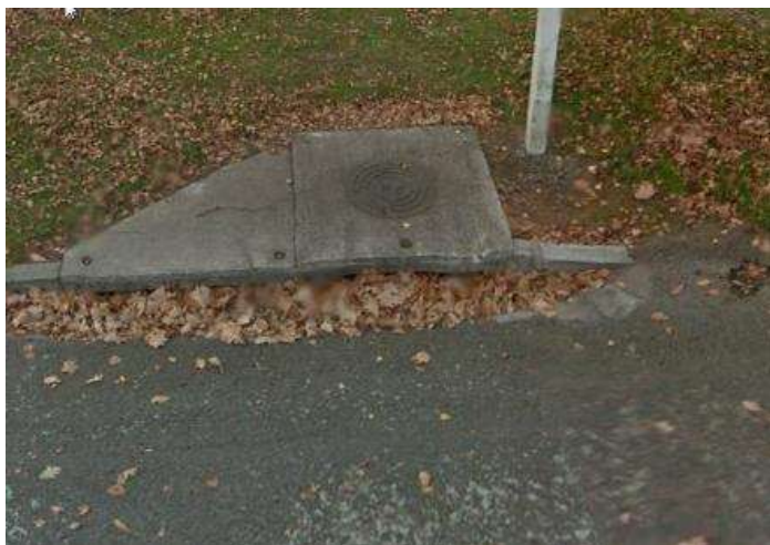
D15 Blocked Sump
